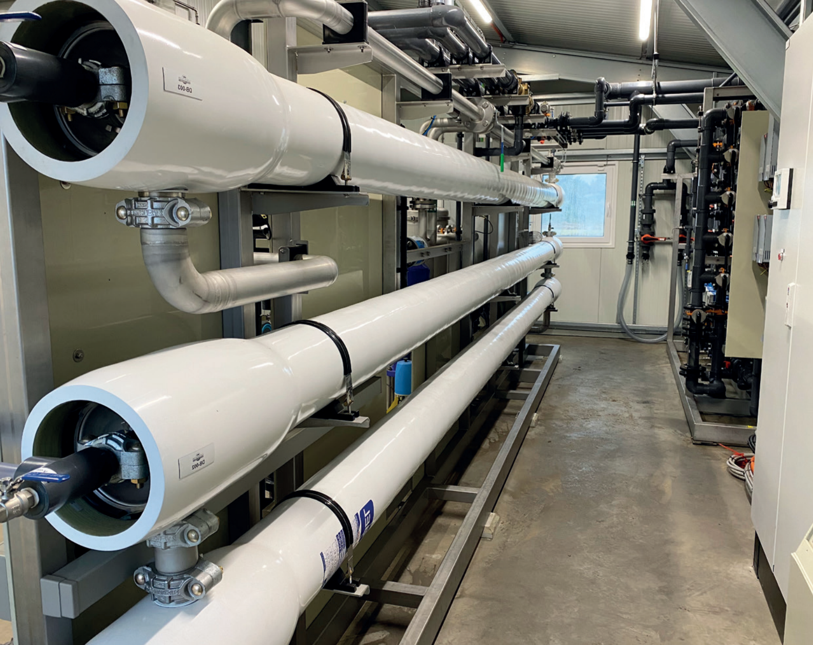
De membraanfilters van de onderzoekspilot Brak grondwater op productielocatie Scheveningen.
